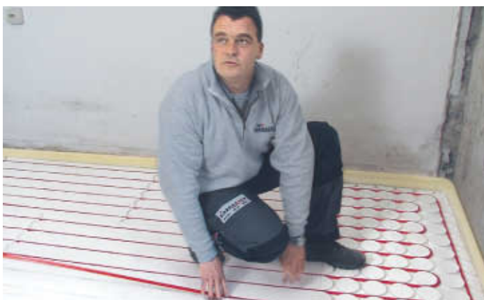
Aus Sicht von Sanitärfachinstallateur Michael Schulz (Birnbacher, Schleching) läuft die Verlegung des neuen PB-Rohres „wie am Schnürchen“.
