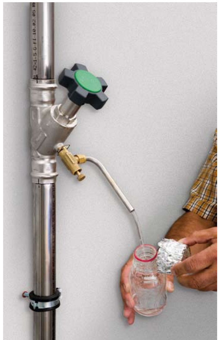
■ Da Trinkwasseranlagen künftig wesentlich häufiger beprobt werden, ist die vorausschauende Installation entsprechender Probenahmeventile sinnvoll.
